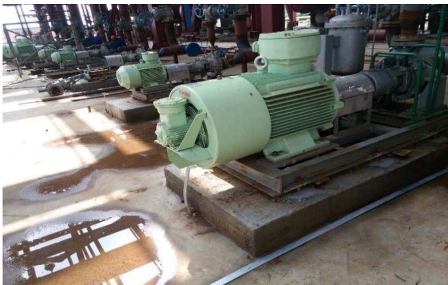
图 2-13 机泵基础减震情况
