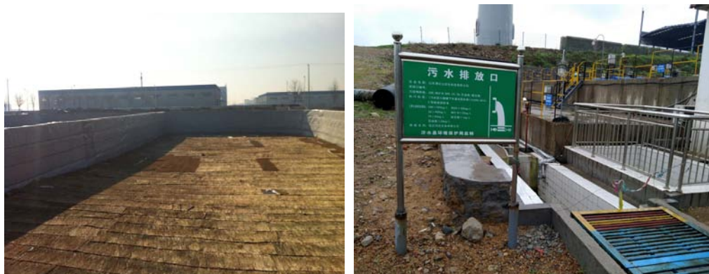
图 6-2b 事故水池及排放口
