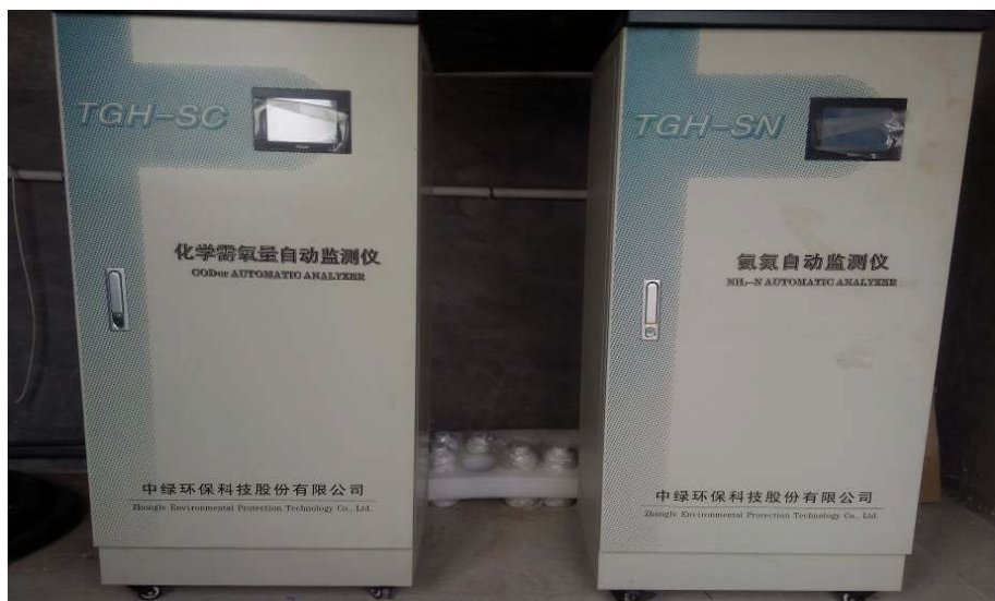
图 7-3c 污水在线监测（COD、氨氮在线自动监测仪）
